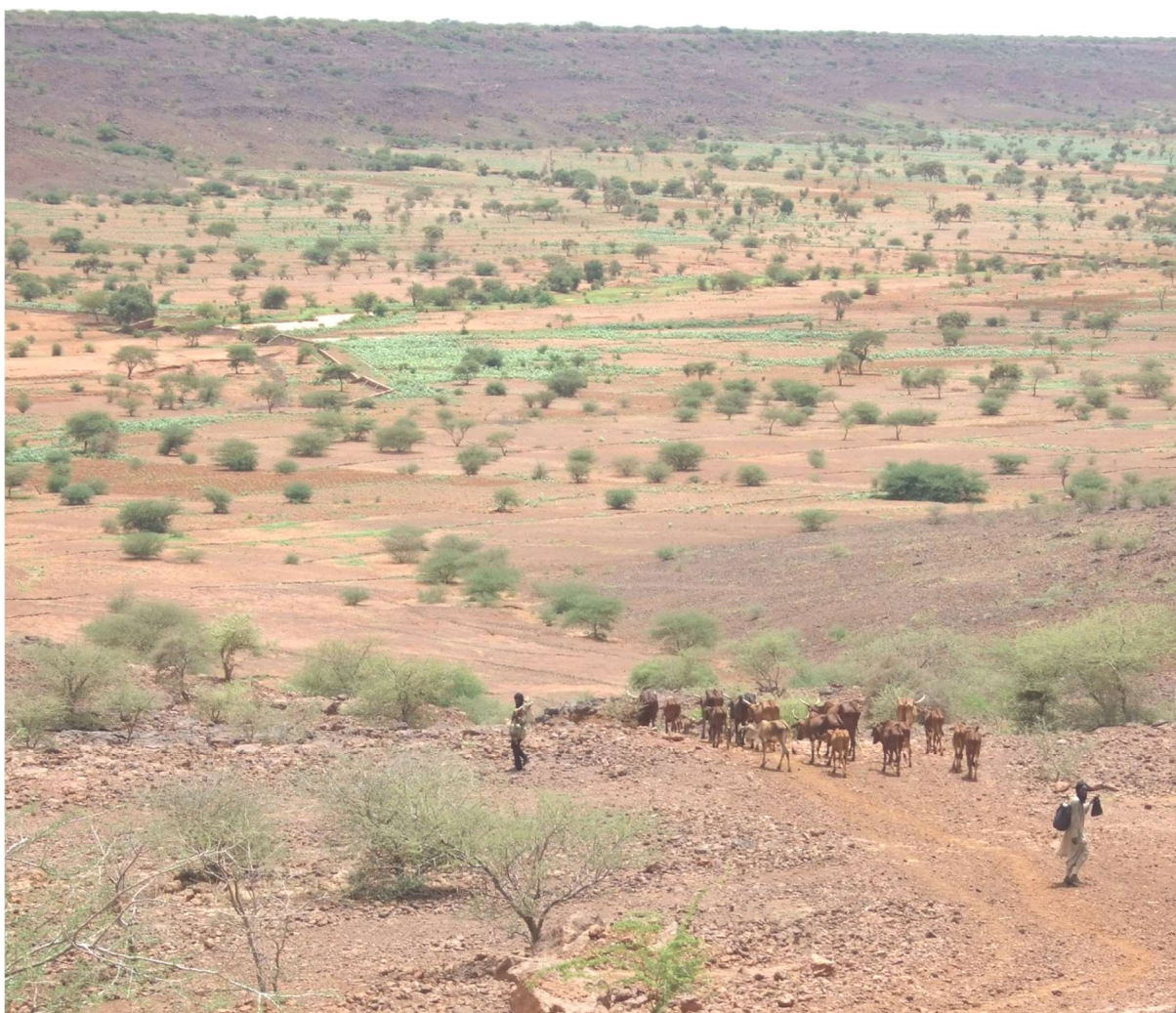
Vue de la mise en œuvre d'une approche bassin-versant dans la vallée de Karadji (observations d'ouvrage de banquettes sur le plateau, des tranchées sur les versants, des cordons de pierres et d'un seuil d'épandage dans les parties basses).
